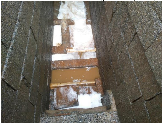
Foto 07: Caixa Separadora de Água e Óleo (CSAO).
