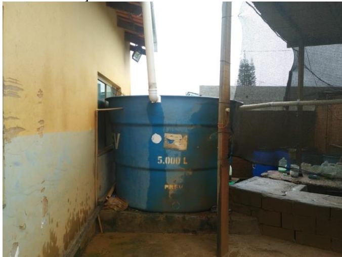
Foto 03: Localização da caixa de armazenamento de 5.000 litros.
