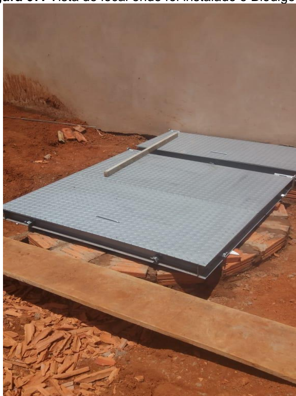
Figura 07: Vista do local onde foi instalado o Biodigestor.
